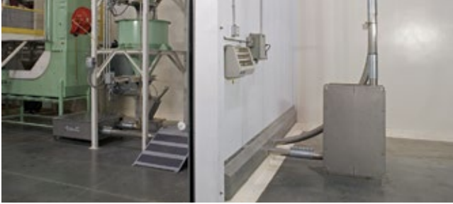
The blend wall. | photo courtesy of Cablevey
